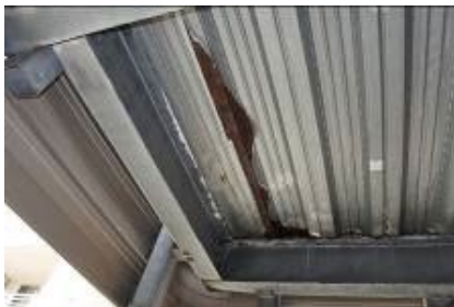
デッキプレートの腐食
