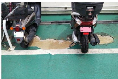
屋上防水の破損
