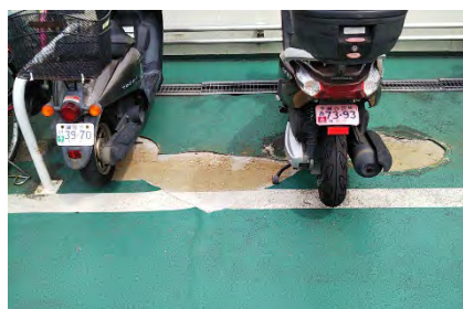
屋上防水の破損
