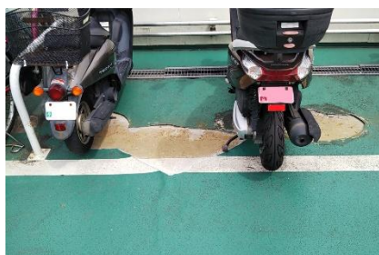
屋上防水の破損
