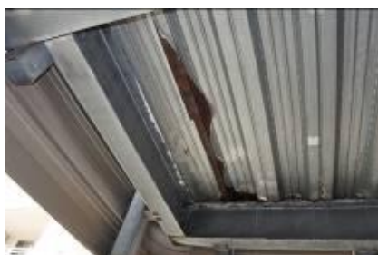
デッキプレートの腐食
