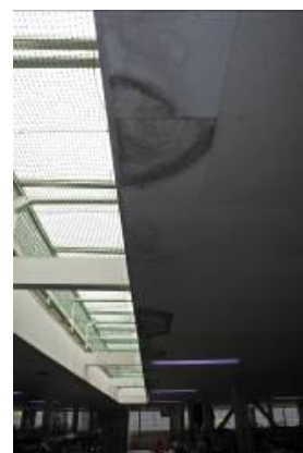
トップライトの雨漏り
