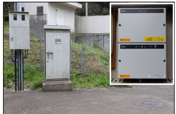
写真-1 小規模ポンプ施設と非常通報装置
