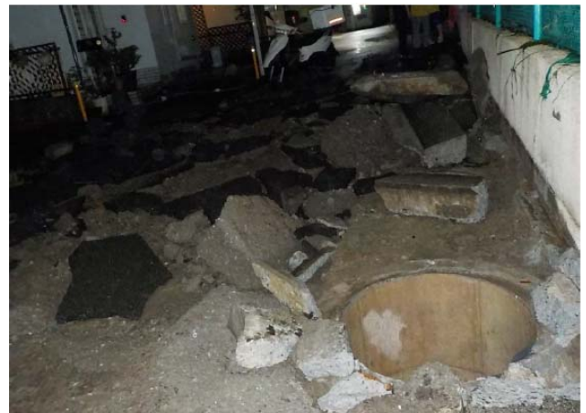
写真-1 マンホール浮上被害の様子
