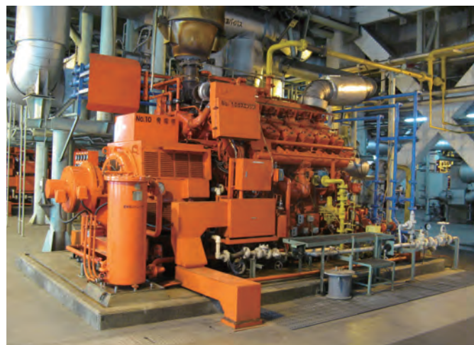
消化ガス発電機
