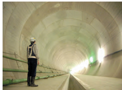
直径6.5mの下水管
