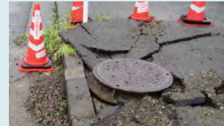
マンホール浮上被害状況
