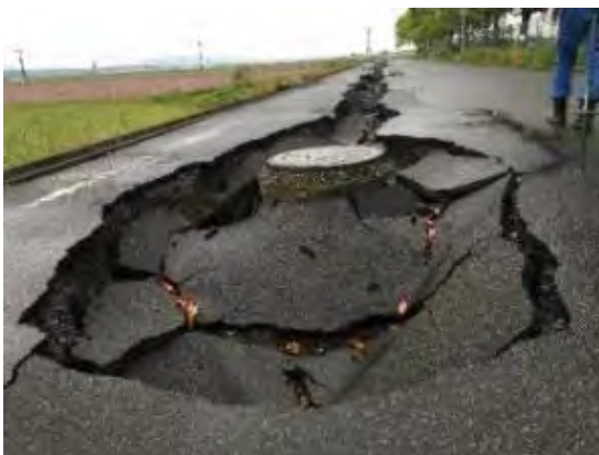
2016（平成28）年 熊本地震被害状況（下水道管）
