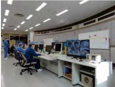
中央操作室での運転管理
