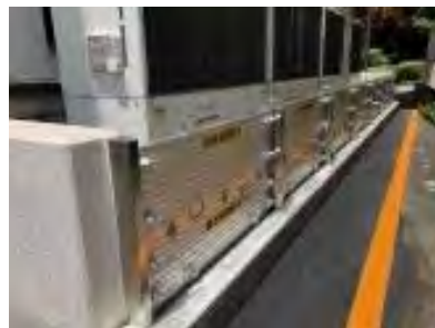
機械設備の耐水化（止水板）
