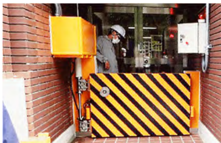
建物の耐水化（防水扉）
