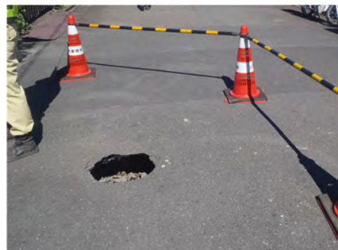
取付管破損による道路陥没の様子
