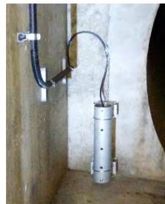
水位計設置状況
