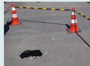
取付管破損による 道路陥没
