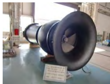
再整備後のポンプ設備
