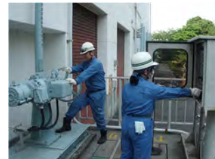
主要設備の点検 ポンプ設備（上） ゲート設備（下）
