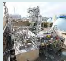
下水汚泥燃料化施設
