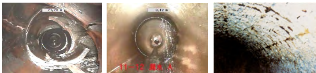
状態監視で見えてきた異常箇所の事例 本管の破損（左） 浸入水（中） 鉄筋の露出（右）
