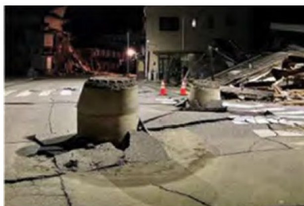
マンホール浮上(輪島市)
