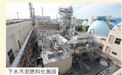
下水汚泥燃料化施設
