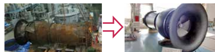
ポンプ設備の再整備(左:再整備前、右:再整備後)
