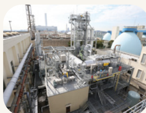
下水汚泥燃料化施設
