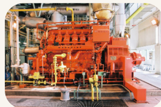
消化ガス発電
