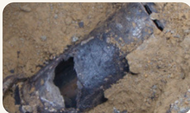
破損したZパイプ
