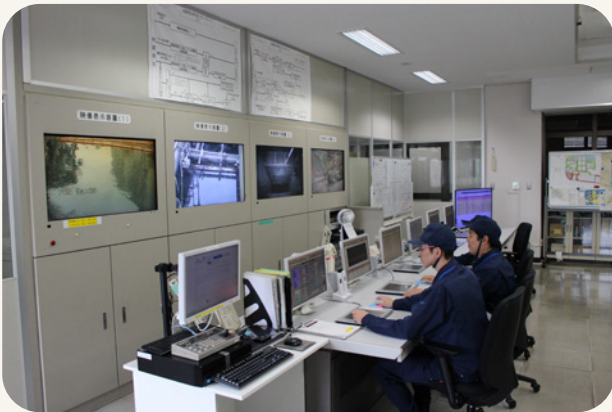
中央操作室での運転管理
