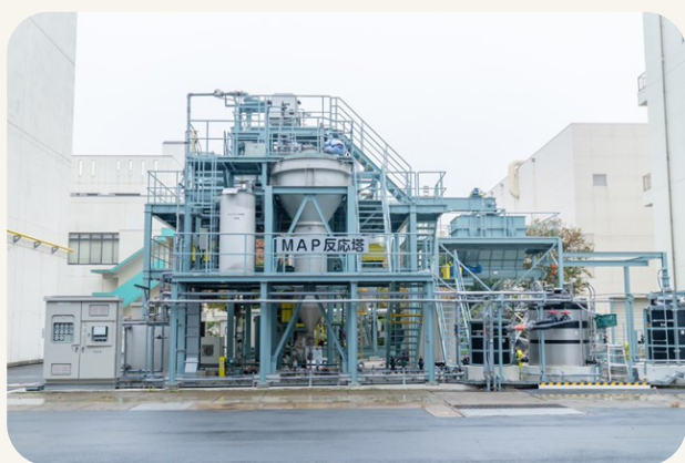
リン回収施設
