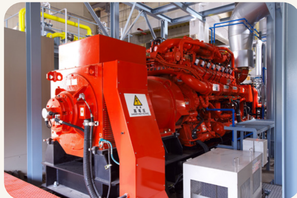
消化ガス発電設備
