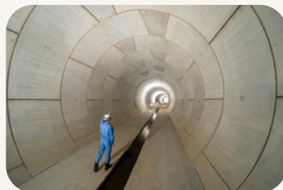
雨水貯留施設(新羽末広幹線)
