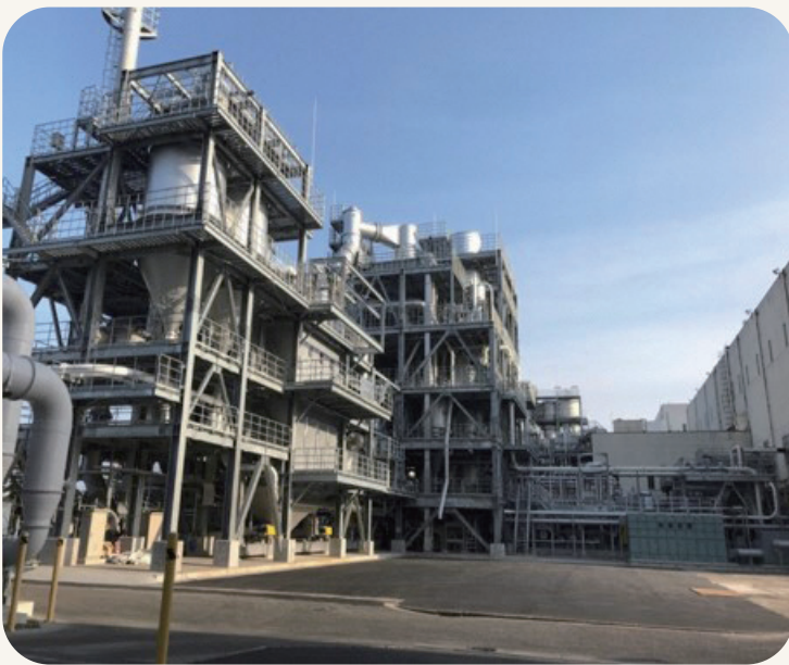
高性能汚泥焼却炉(北部汚泥資源化センター)
