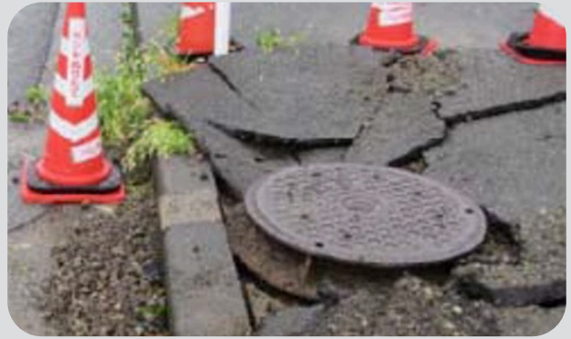
マンホール浮上被害状況
