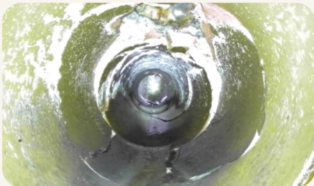
破損した陶管
