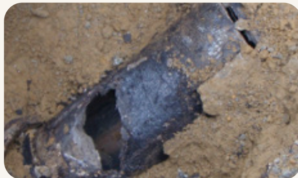
破損したZパイプ
