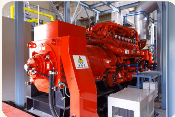
消化ガス発電設備
