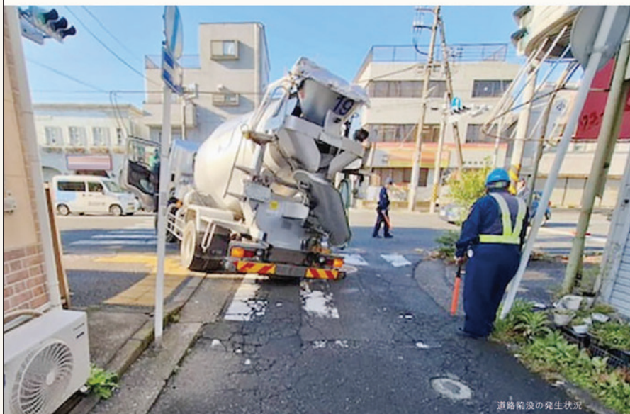
道路掃設の発生状況
