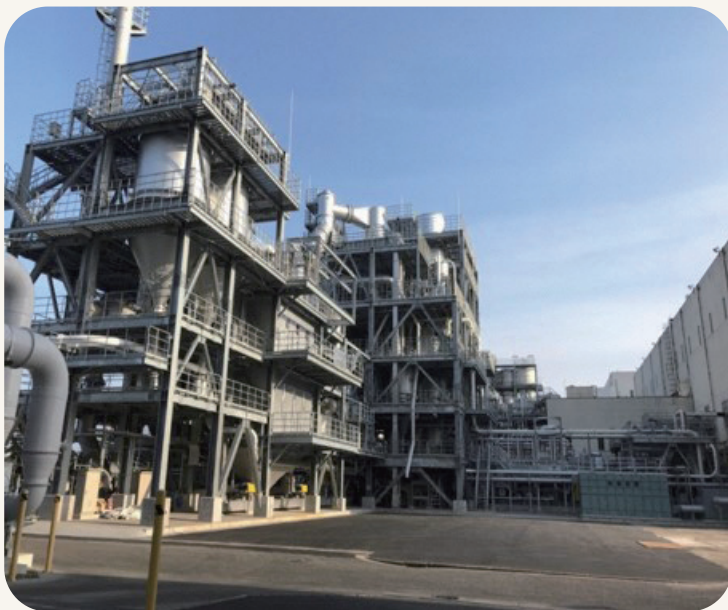
高性能汚泥焼却炉(北部汚泥資源化センター)
