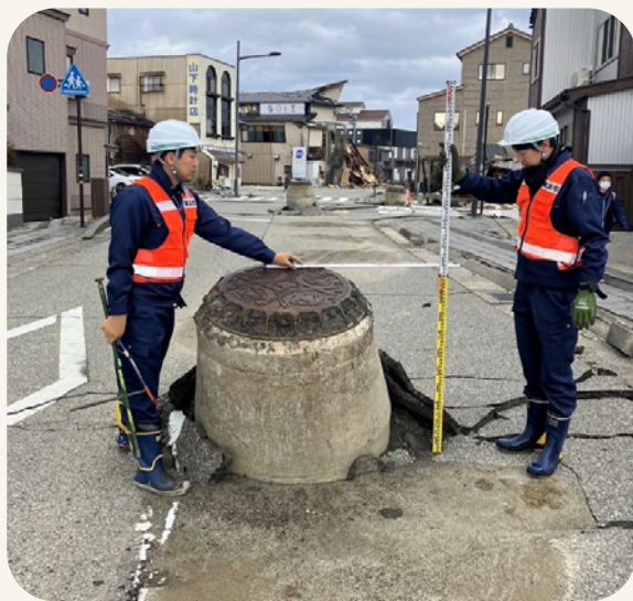
マンホールの被害状況(能登半島地震)
