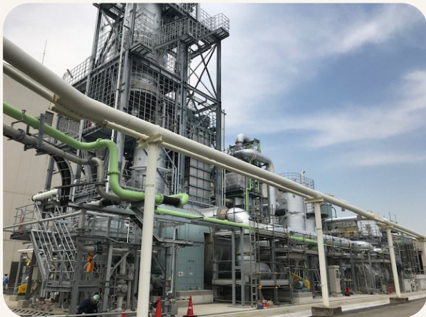
汚泥燃料化施設
