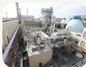
下水汚泥燃料化施設
