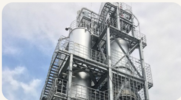
汚泥燃料化設備(南部汚泥資源化センター)
