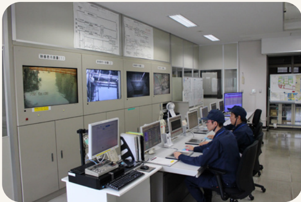
中央操作室での運転管理
