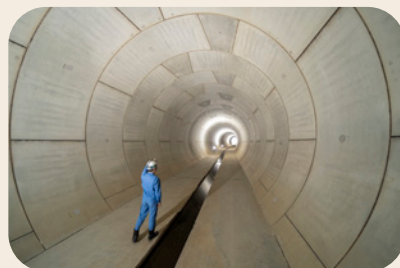
雨水貯留施設(新羽末広幹線)
