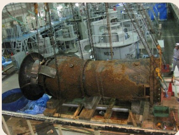
再整備前のポンプ設備
