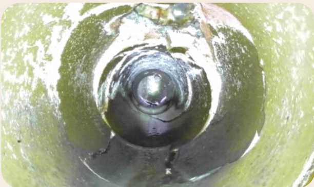
破損した陶管
