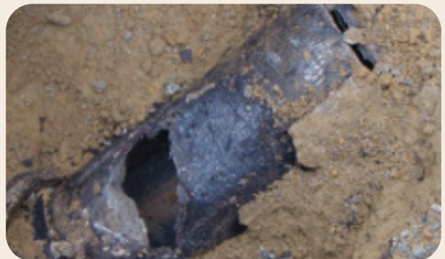
破損したZパイプ
