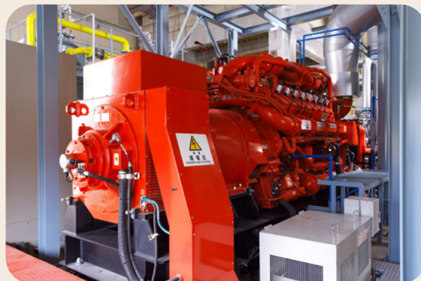
消化ガス発電設備
