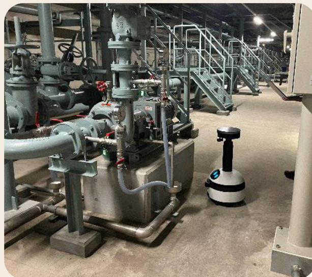
AGVでの自動巡回点検実験の様子
