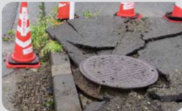
マンホール浮上被害状況
