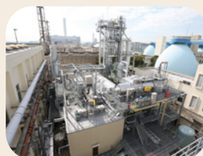
下水汚泥燃料化施設
