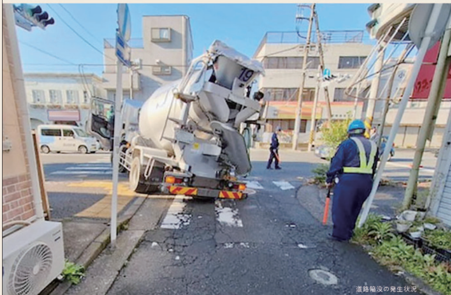
道路陥没の発生状況
