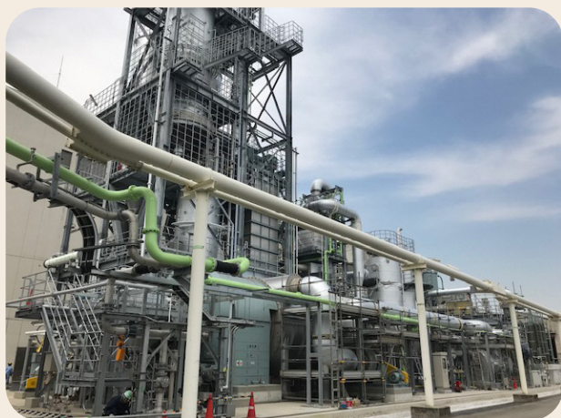
汚泥燃料化施設
