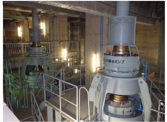
第二ポンプ施設 雨水ポンプ
