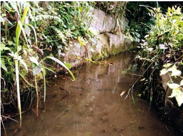
写真－2 BRの石積護岸、底面コンクリート水路、堰上に砂泥堆積、護岸にミズゴケが繁茂する
