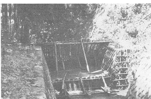
写真-6 氷取沢・清戸川の氷取沢合流点付近に設置された流出物の流下を防ぐための木柵(1985年5月)
