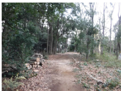
【危険樹木の伐採】 大貫谷公園（旭区）
