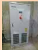
蓄電池の設置
