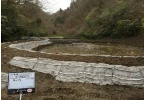
池に近い沈砂池
