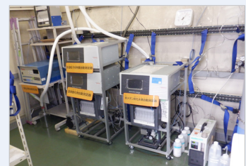
図 4-16 測定局舎内の測定機器
