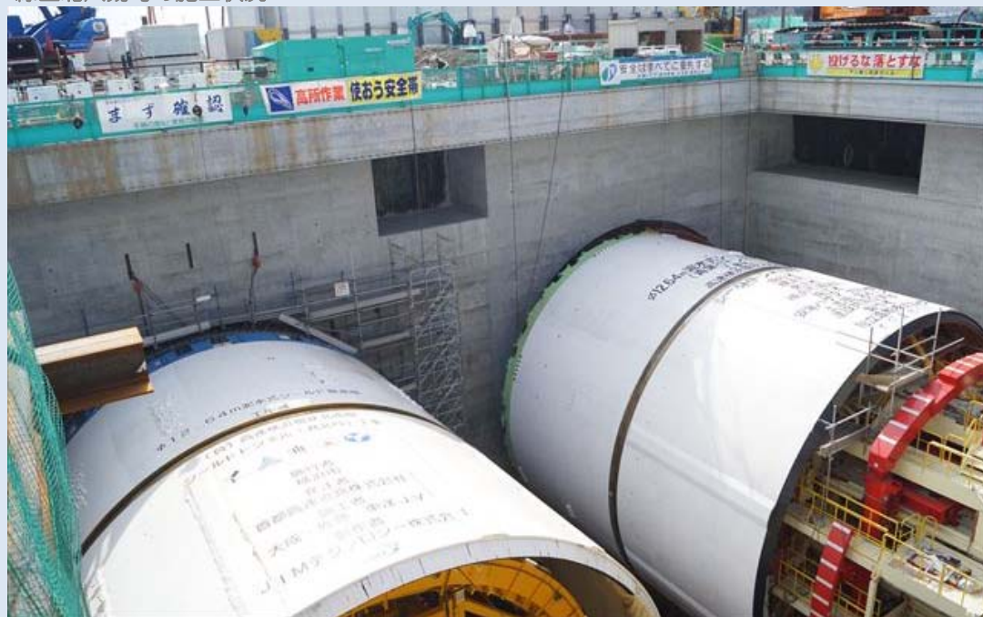
② 発進立坑の様子(H29.2撮影) (発進立坑内でシールドマシン組立て中)
