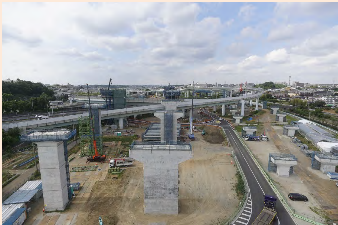
① 橋梁工事の様子(H29.6撮影) (橋脚上に上部工の足場建設中)
