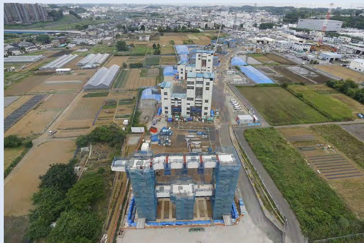
⑥横浜港北JCT付近の橋脚建設の様子 (H29.6撮影) (⑤の反対側を撮影)
