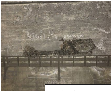
損傷(表面劣化)
