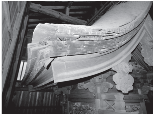
20 篠塚八幡社本殿 柿葺屋根の軒付損傷部分 (背面北側面)
