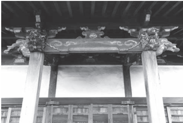
3 如来堂向拝見上げ 虹梁の絵様、木鼻彫刻、臺股の意匠は 18 世紀後期頃の特徴を示し、過去帳が伝える安永 3 年 (1774) 建築は妥当といえる。
