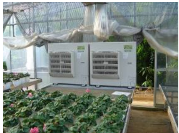
【写真】ヒートポンプを設置した温室
