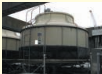
冷却塔（クーリングタワー）
