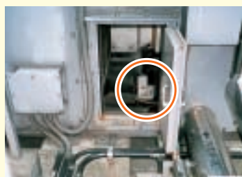
空調機内に設置された加湿装置
