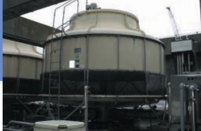
冷却塔（クーリングタワー）
