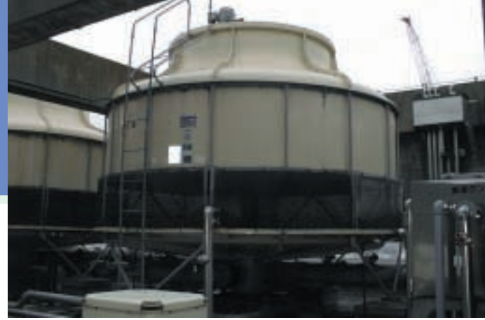
冷却塔（クーリングタワー）
