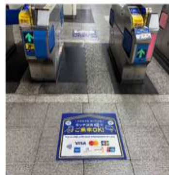
専用リーダーが設置された改札機
