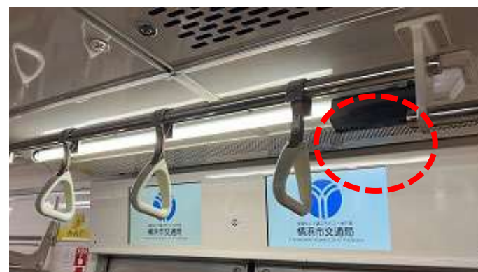
〈3000R形車両に設置した防犯カメラ〉
