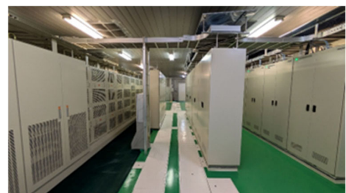
▲新羽駅機器室（更新後）
