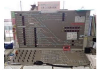
▲連動制御盤（連動装置）
