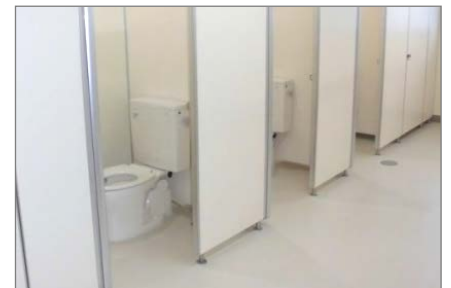
<トイレの洋式化事例>
