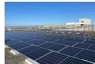
太陽光発電設備
