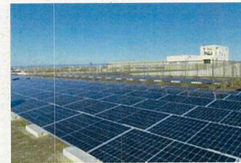
太陽光発電設備
