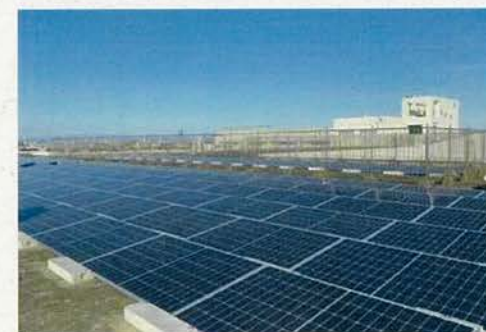
太陽光発電設備
