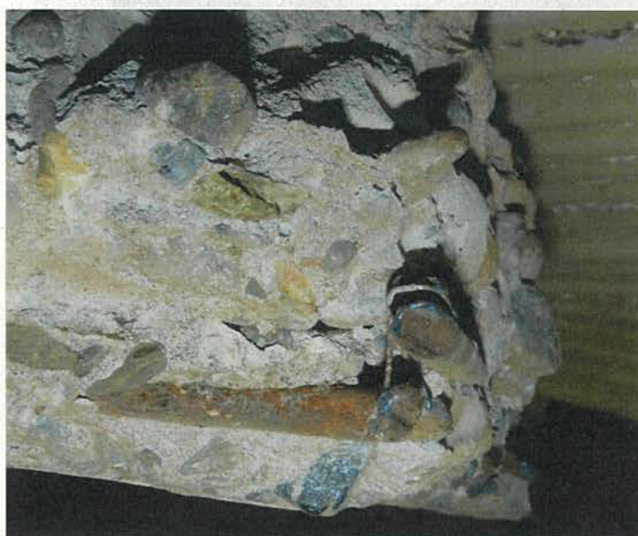
写真 9 旧三井物産横浜支店倉庫部材 屋根スラブ片 配筋詳細
