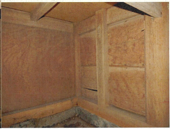
篠塚八幡社本殿 内部（身舎側面と背面） 切石礎石内面は木製土台際より若干出る程度に配置する。身舎側面は柱間中間に腰組用の束を挿入している。背面羽目板は檜の立派な一枚板である。
