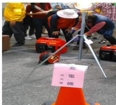
発電機運転と投光器点灯
