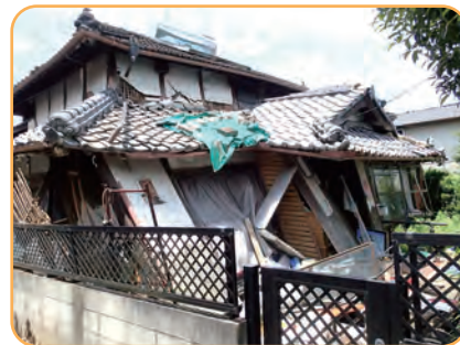
平成28年 熊本地震による被害(熊本県内)
