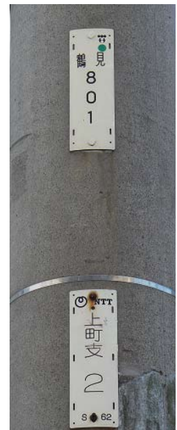
東京電力も使用しているNTT柱
