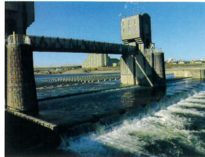
用水への取水口 宿河原の堰
