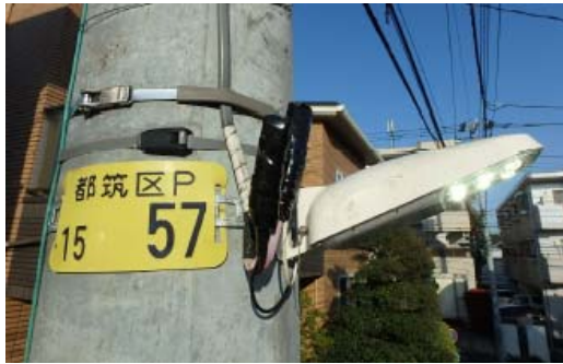
(電柱に取り付けられた防犯灯の例)
