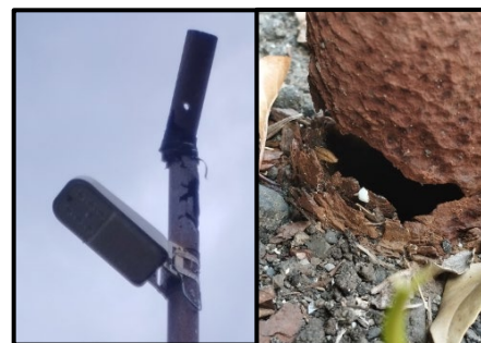
ポールの劣化事例
