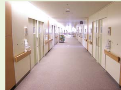
手すりが連続していない
