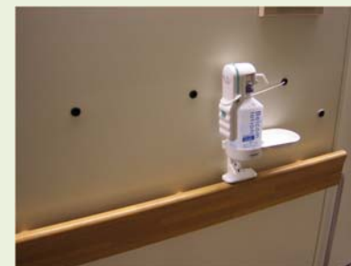
手すりに手指消毒液を設置している
