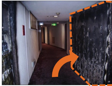
防火戸を開けた状態 ※点線部＝防火戸
