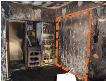
火災発生現場
