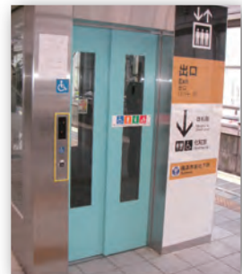
■エレベーター 上下線ホームに1基ずつ できました。
