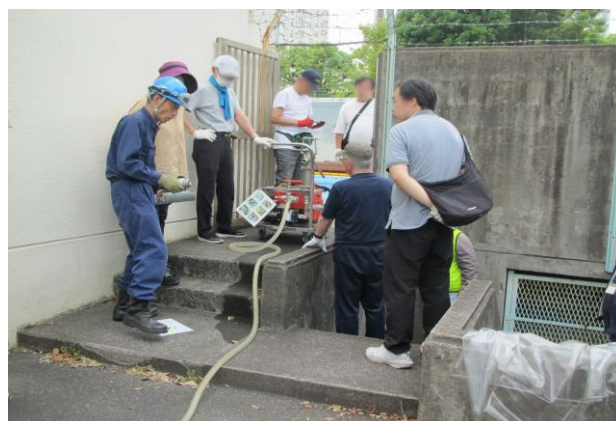
給水ポンプ操作
