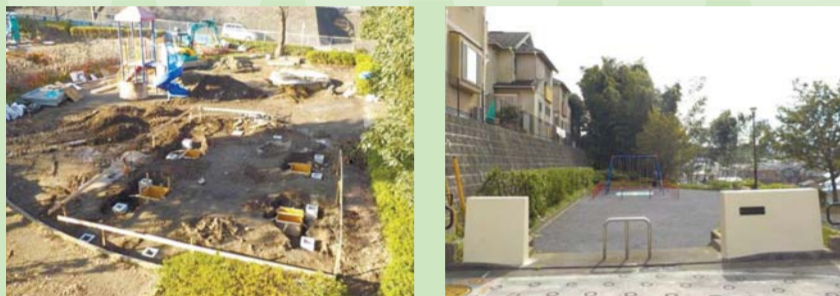
幼児の利用が多い弥生台駅前公園は全面閉鎖して古くなった施設を新しくしています 遊具や舗装等を新しくして樹木を整理することで全体が明るくなった岡津南公園
