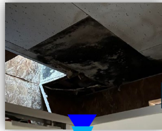
雨漏りトイレ天井
